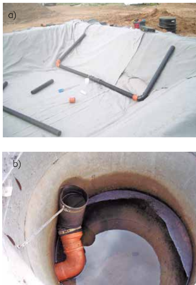
Figura 13. a) Instalación de tubería de evacuación de aguas tratadas y b) Sistema de regulación de nivel por medio de una cadena.
