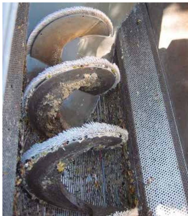
Figura 5. Funcionamiento de rejilla automática. PTAS de Corbins. Fuente: Elaboración propia
