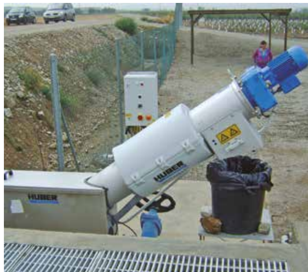
Figura 4. Rejilla automática utilizada en la PTAS de Verdú. Fuente: Elaboración propia
