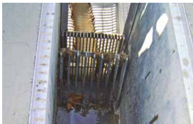
Figura 3. Combinación de rejillas manuales utilizadas en la PTAS de Alfés. Fuente: Elaboración propia
