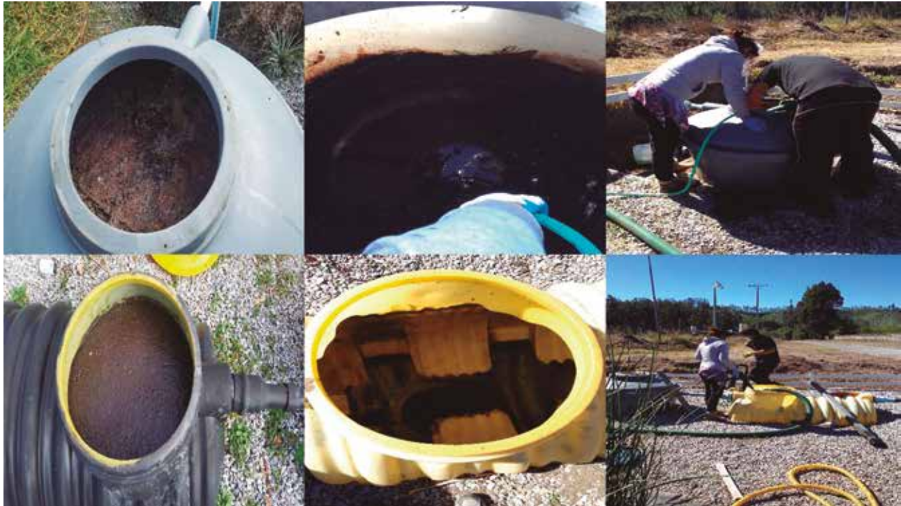
Figura 25 Mantención del tratamiento primario. Fuente: Elaboración propia.
