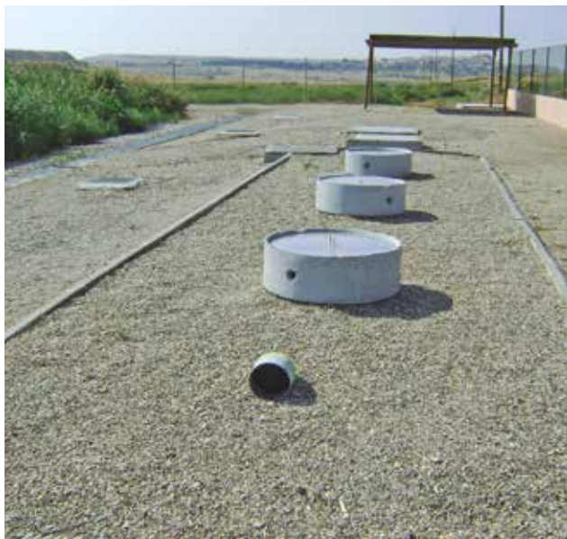
Figura 6. Fosa séptica utilizada en la PTAS de Alfes. Fuente: Elaboración propia
