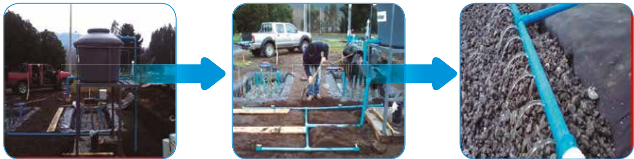
Figura 17 Estructuras de entrada del agua servida tratada en el humedal construido. Fuente: Elaboración propia
