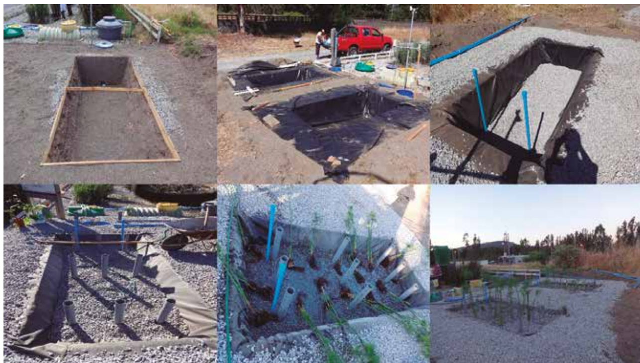
Figura 19 Tercera etapa de construcción de planta piloto de humedales construidos. Fuente: Elaboración propia
