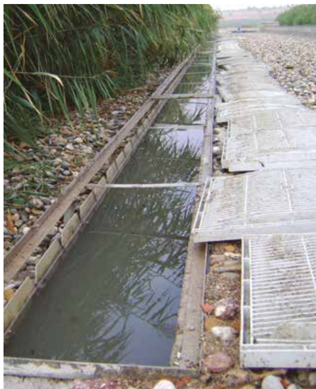
Figura 9. Canales de alimentación a los HFSS en la PTAS Verdú. Fuente: Elaboración propia
