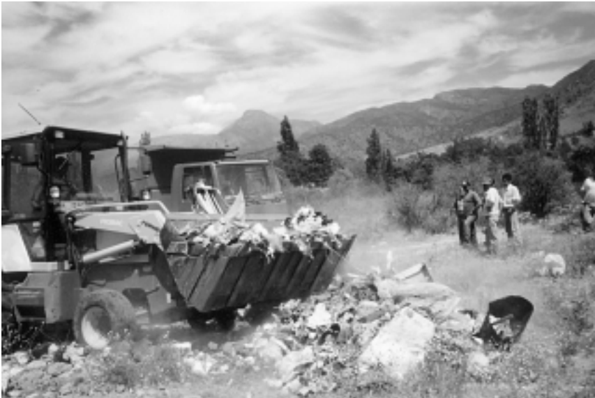
Fotografía 3. Con el apoyo de un camión tolva y un cargador frontal, fue posible descongestionar el vertedero de Alhué. Se estima que fueron cargadas más de 4 toneladas de residuos (10% del total mensual). Las basuras fueron depositadas en el relleno sanitario de Popeta (Provincia de Melipilla).
