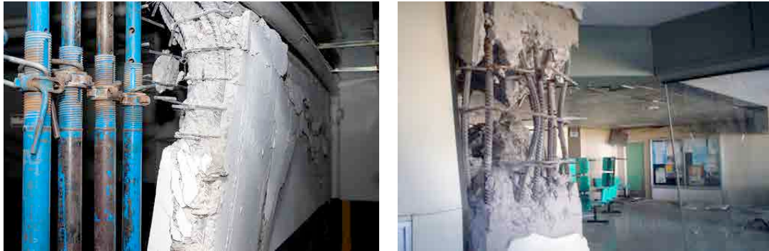
Imagen 3.14-3.15 Daños estructurales en edificios. Terremoto Chile 2010. Fuente: diarioUchile
