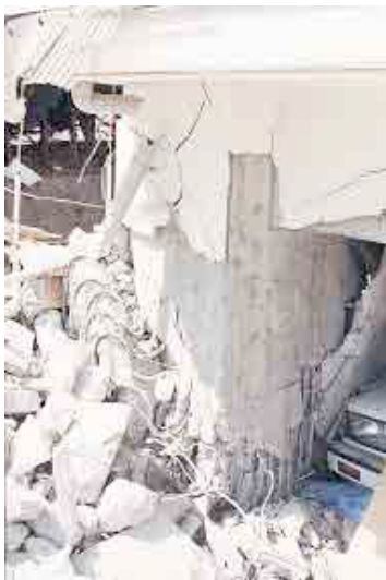
Figura 7.23 Detalle elemento constructivo. Kobe, Japón 1995.
