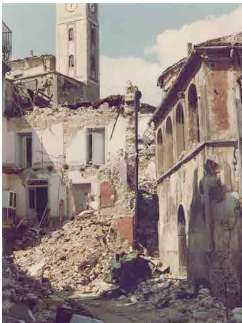
Figura 5.25 Derrumbes en Calabritto.
