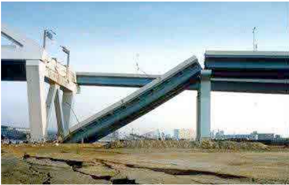
Figura 7.30: Kobe 1995 - daños a la autopista elevada que va de Kobe a Osaka
