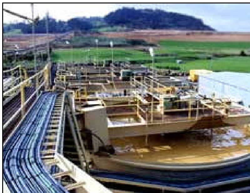
Fig. 13. Vista parcial de los tanques de lixiviación de la mina Martha (Nueva Zelanda).
