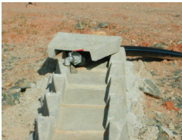
Fig. 79. Detalle de la tubería que alimenta al sistema, a través de la cascada de aireación.
