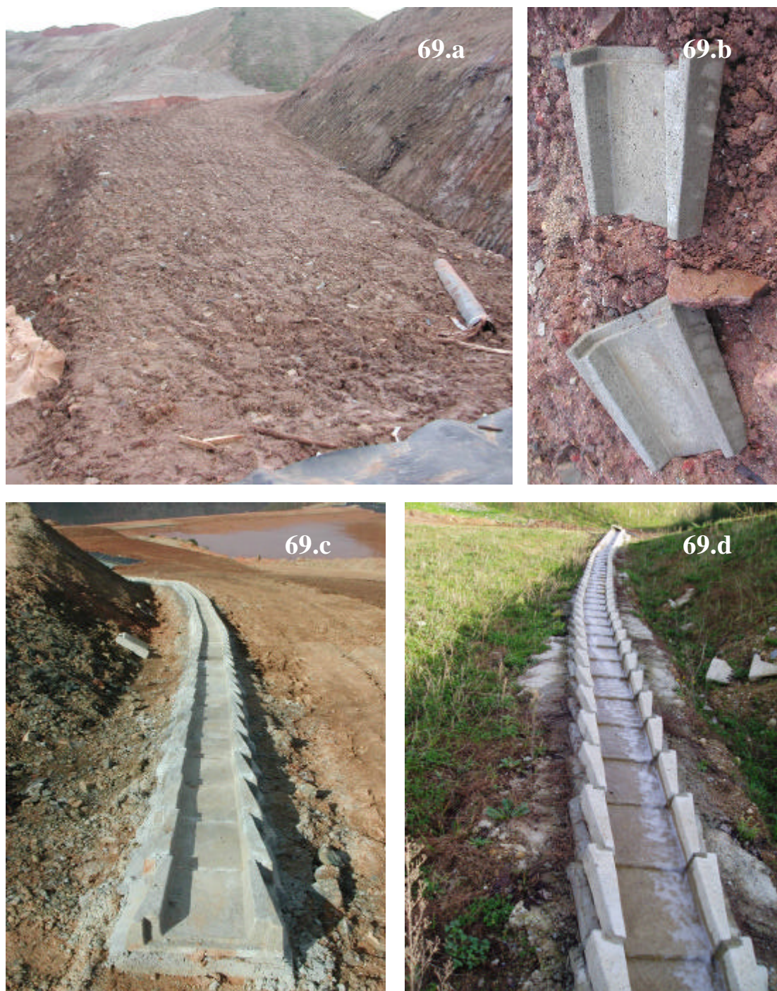
Fig. 69. Vistas de la cascada de oxidación que actúa como pretratamiento en el sistema pasivo piloto:
