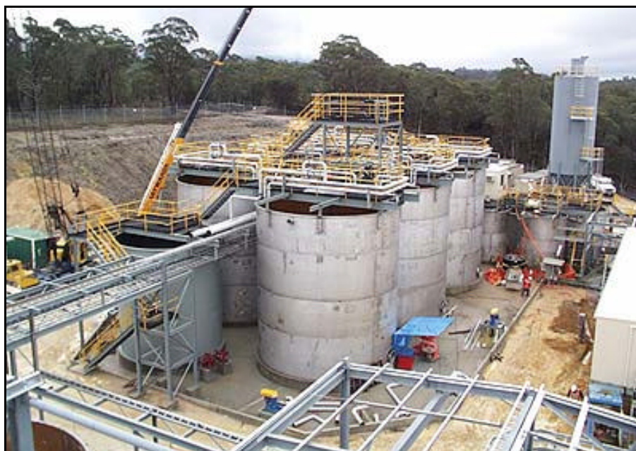
Fig. 25. Tanques para proceso a escala real de oxidación biológica (mina Beaconsfield)
