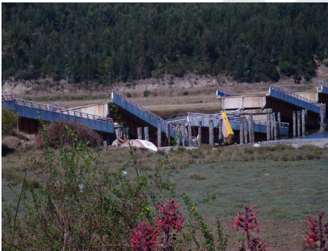
Fig 2: Caleta Tubul. Se observan botes colgando en el puente indicando que el tsunami se encauzó en el Río Tubul.
