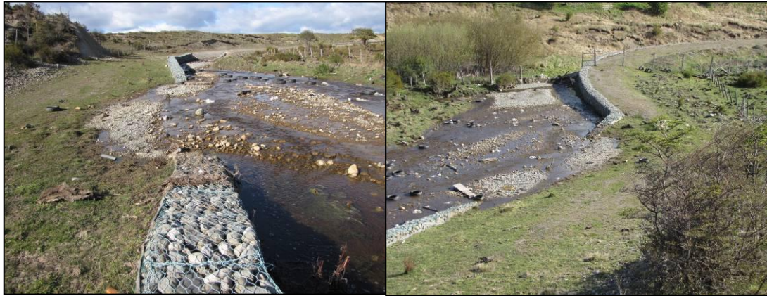
Fotografía 93: Derrumbe de gaviones en sector de antiguo cauce natural, H. Gómez.
