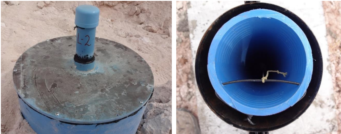
Figura-12: Instalación del Dipper APT y sellado de tapa de estanque (izquierda). Sistema de soporte del Dipper APT.
