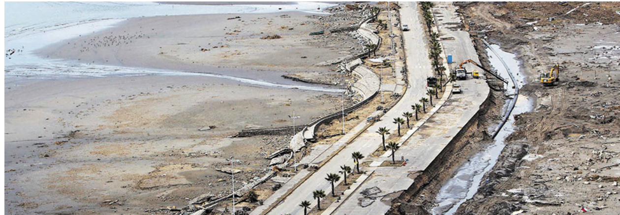
Estado de la Av. Costanera, sector desembocadura El Culebrón, posterior al tsunami del 16 de Septiembre del 2015. La Tercera (2015). Recuperado en: http://www.latercera.com/noticia/inversion-del-mop-tras-terremoto-en-la-iv-region-llega-a-los-8-mil-millones/
