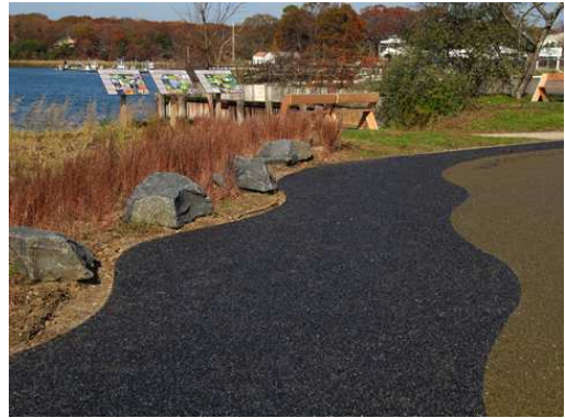
Figura 77. Lillian Ball. WATERWASH® Mattituck, New York, 2007- 2009. Pavimento permeable de vidrio reciclado que absorbe agua y previene la llegada de agua de escorrentía al Arroyo Mattituck.
