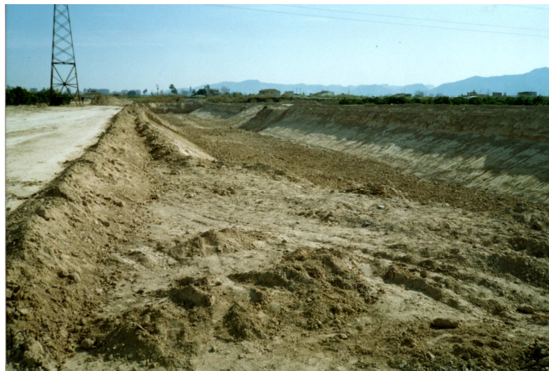
Figura 101. Obras de encauzamiento del Río Segura a su paso por Rincón de Beniscornia al inicio de los años 90. Excavación del nuevo cauce.
